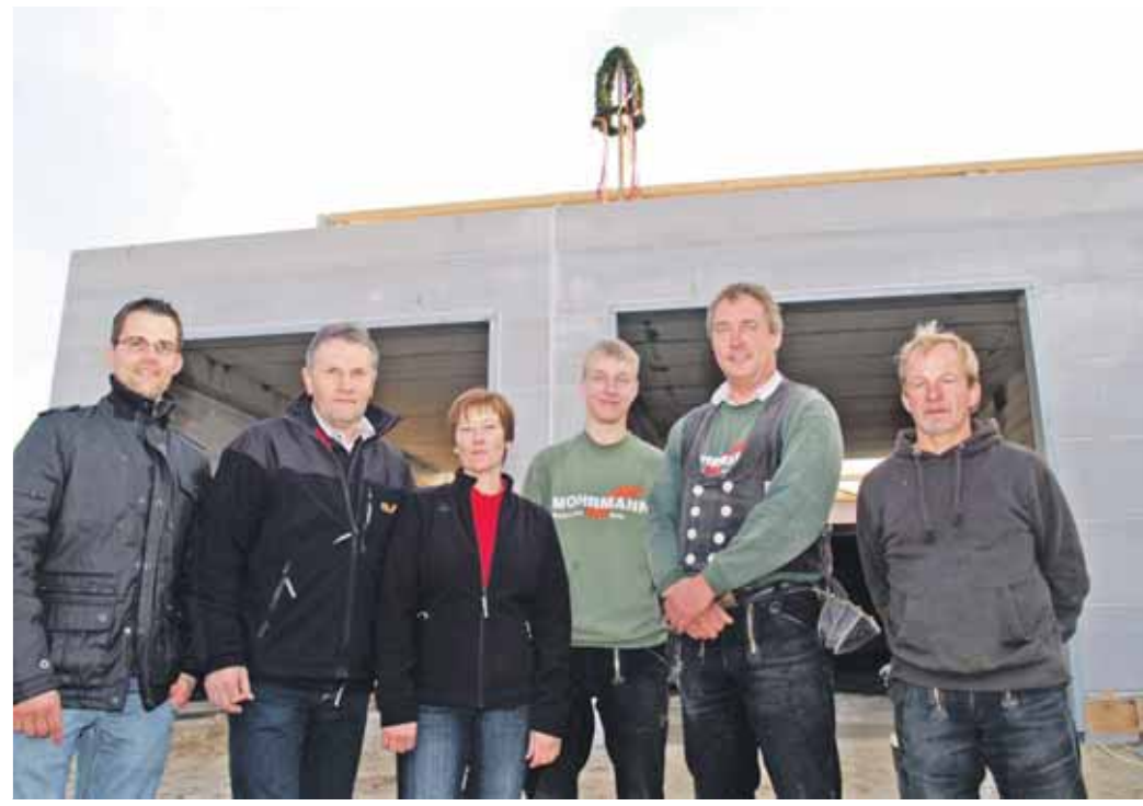
Die Bauherren freuen sich mit den Zimmerleuten, dass das Gebäude gerichtet werden konnte.
